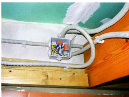
↑ Электрическая распределительная коробка.
